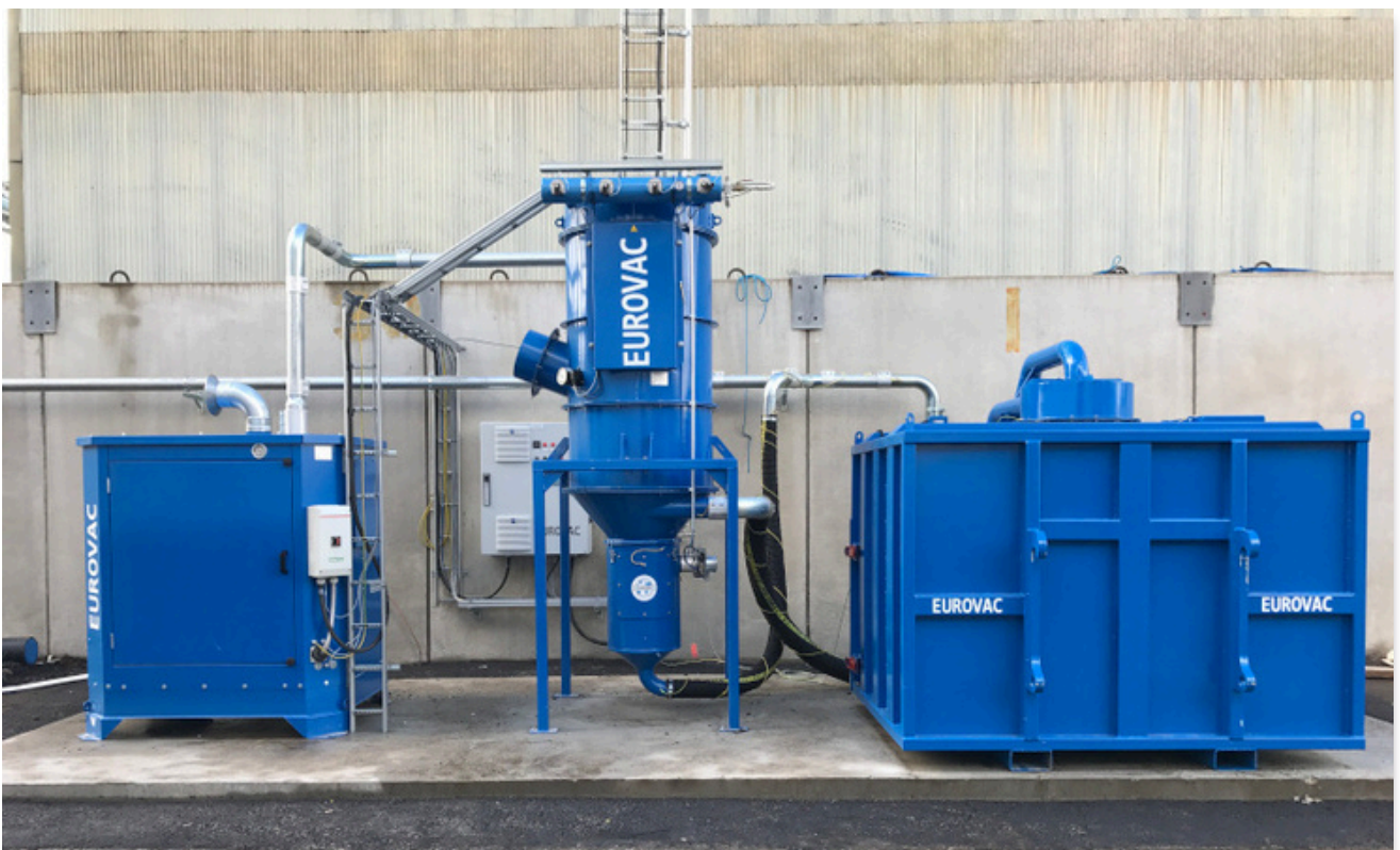
Eurovac 900 -suodatinyksikkö, 5 m 3 esierottimella ja 37 kW kiertomäntäyksiköllä
