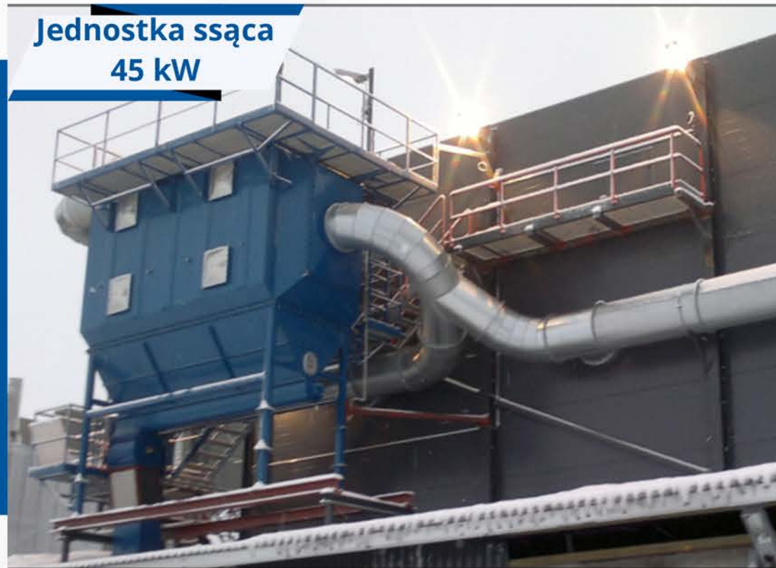
Instalacja odpylania przy odbiorze torfu i zrębków (wiórów drzewnych)
