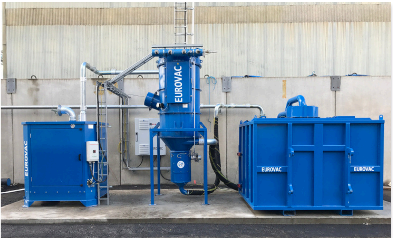
Eurovac 900 -suodatinyksikkö, 5 m 3 esierottimella ja 37 kW kiertomäntäyksiköllä
