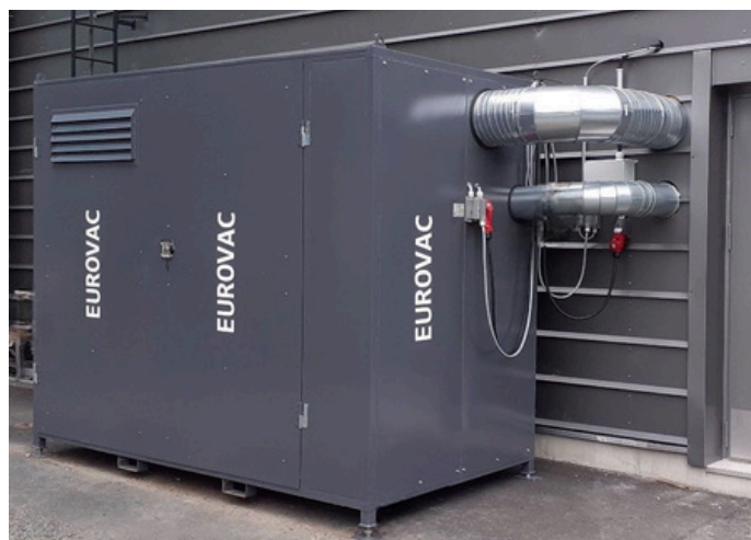
EUROVAC- PURUNPOISTON LAITEHUONE
