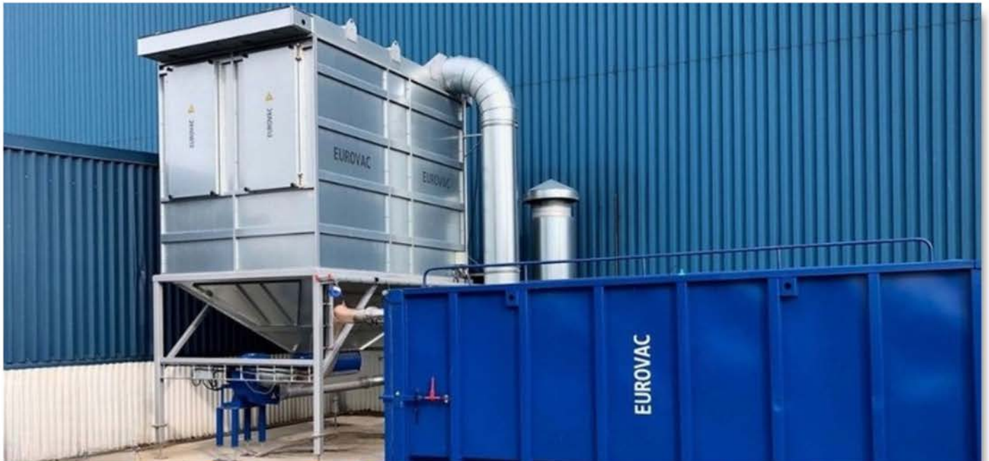
Landskrona Energi, Sweden, Eurovac- Staub- und Späneabsauganlage installiert Eurovac PP80 Filter- und Saugaggregat 30 kW Zentrifugalgebläse Späneabsaugung in Wechselbehälter
