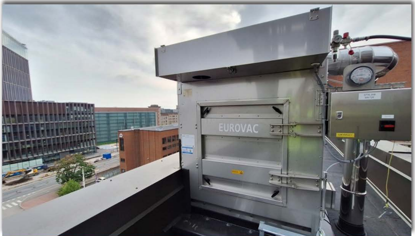
Entstaubungssystem Eurovac PP20-Filteranlage 2,2 kW Zentrifugalgebläse Entstaubungssystem aus Edelstahl
