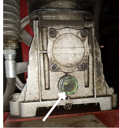
Tarkista öljytaso kompressorin tarkistusikkunasta.
