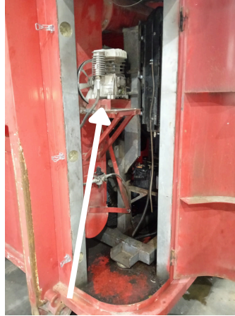
Paineilmakompressori sijaitsee konehuoneessa.
